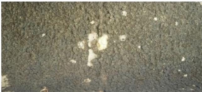
Abbildung 15 An der Innenwand einer Klärschlammleitung haftende Schlammschicht [Foto: SLV Mannheim 2008]
