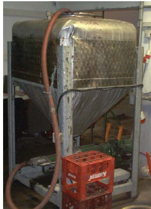
Bild 14: aufgeständerter viereckiger Behälter, Edelstahl, 1000 Liter
